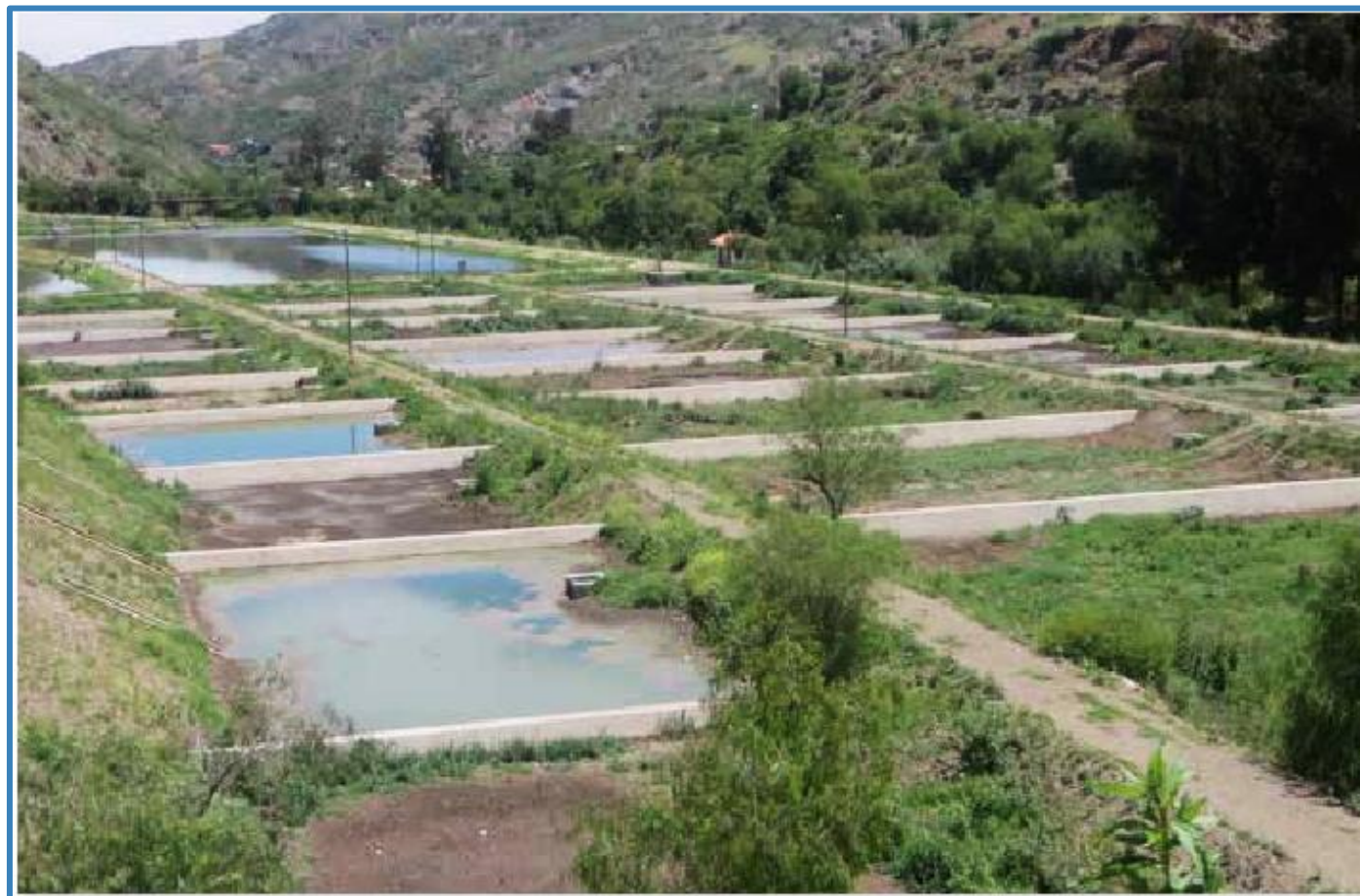
FIGURA 26: LECHOS DE SECADO, PTAR SUCRE
