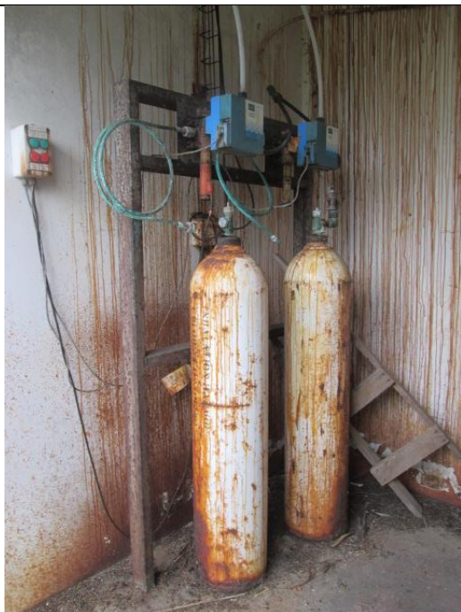
Tanques de cloro (paredes denotan la fuga ocurrida)
