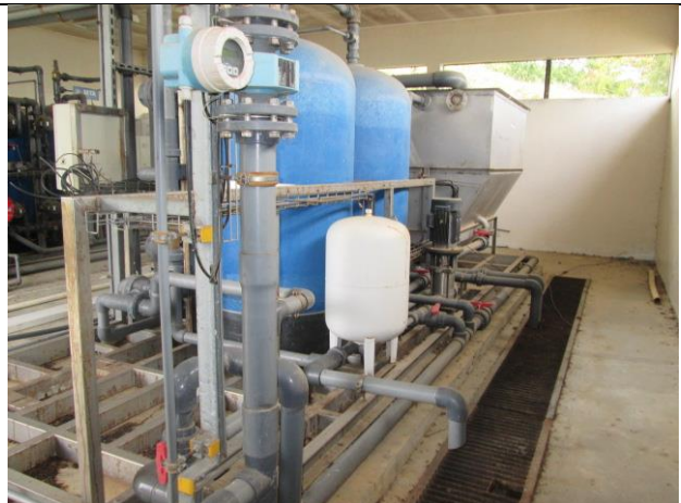
Decantadores y filtros
