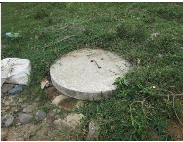
Pozos tipo red colectora del sistema de alcantarillado
