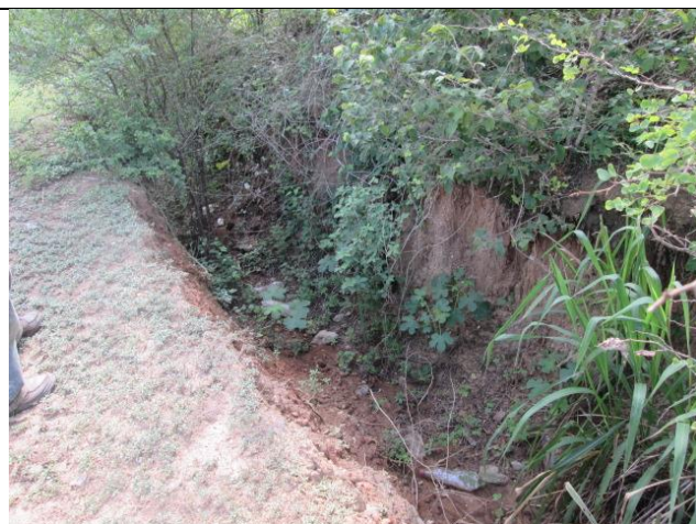
Zanjos de tubería faltan para llegar a las lagunas
