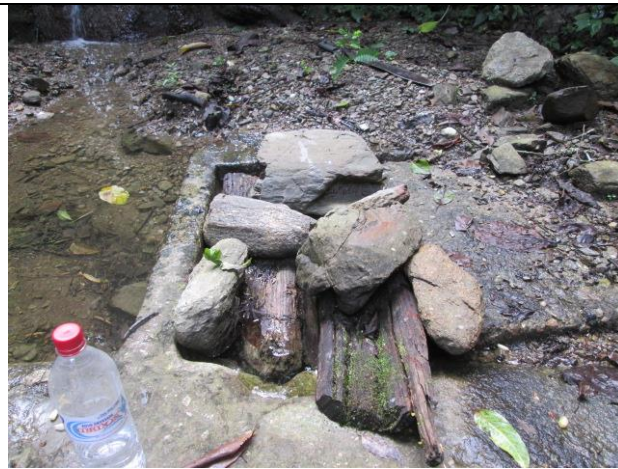
Falta de tapadera en caja de captación
