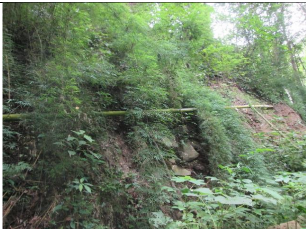
Línea de Conducción de presa Los Galeas sin anclajes
