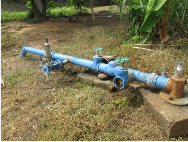
Pozo tubería de salida y válvulas
