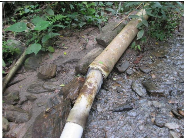
Línea de Conducción de presa Los Galeas
