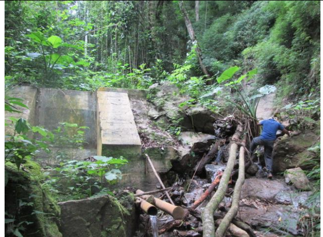
Parte de presa destruida
