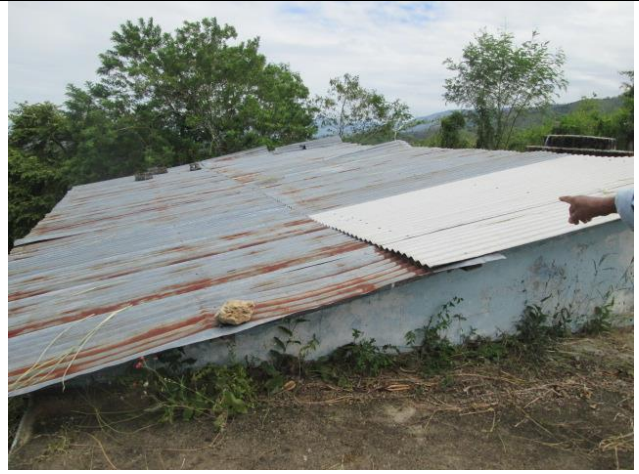
Tanque viejo, que funciona como desarenador
