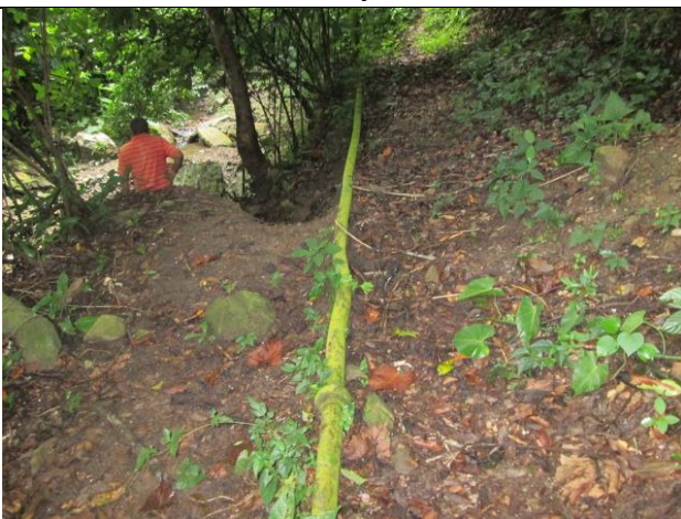
Tubería de HG de 3" sin anclajes
