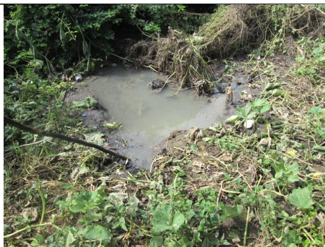
Tramo o pozo obstruido (el agua se dispersa en la zona antes de llegar a las lagunas)
