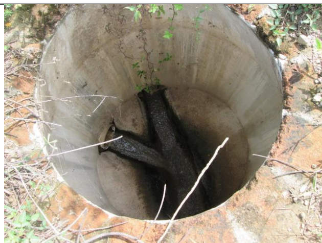
Pozo de visita sin tapadera en el colector que va hacia las lagunas
