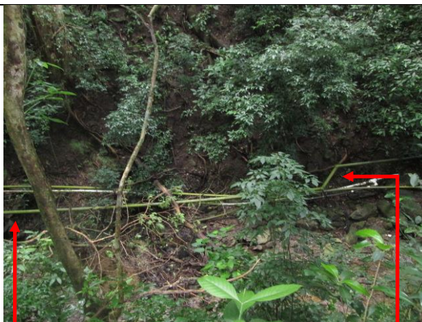
Tubería de HG de 3" sin anclajes
