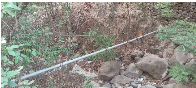
Paso aéreo de tubería del sistema de Concepción de María centro
