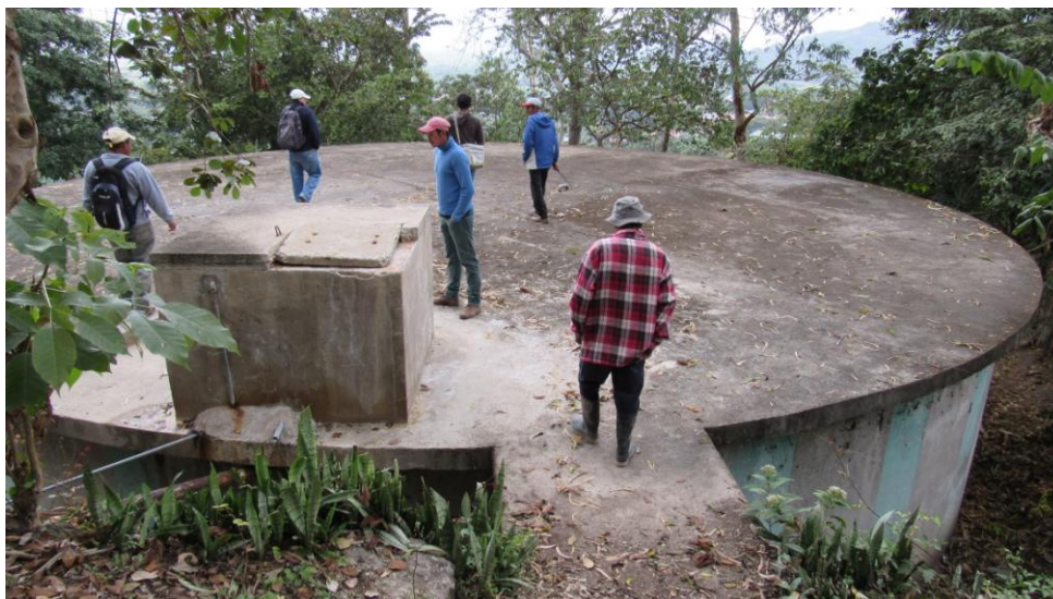
Tanque de 80,000 gls
