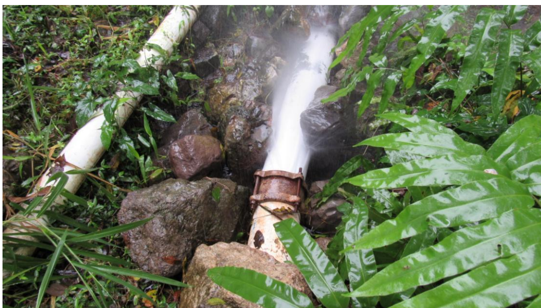
Línea de Conducción, Fuga de agua y tubería expuesta al suelo
