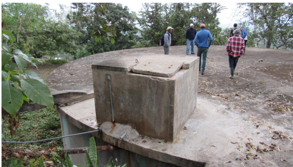
Hipoclorador en mal estado, tanque de 80,000 gls
