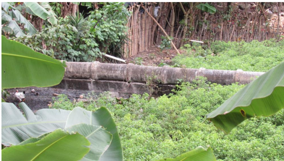
Entrada de colector a la Laguna de Oxidación
