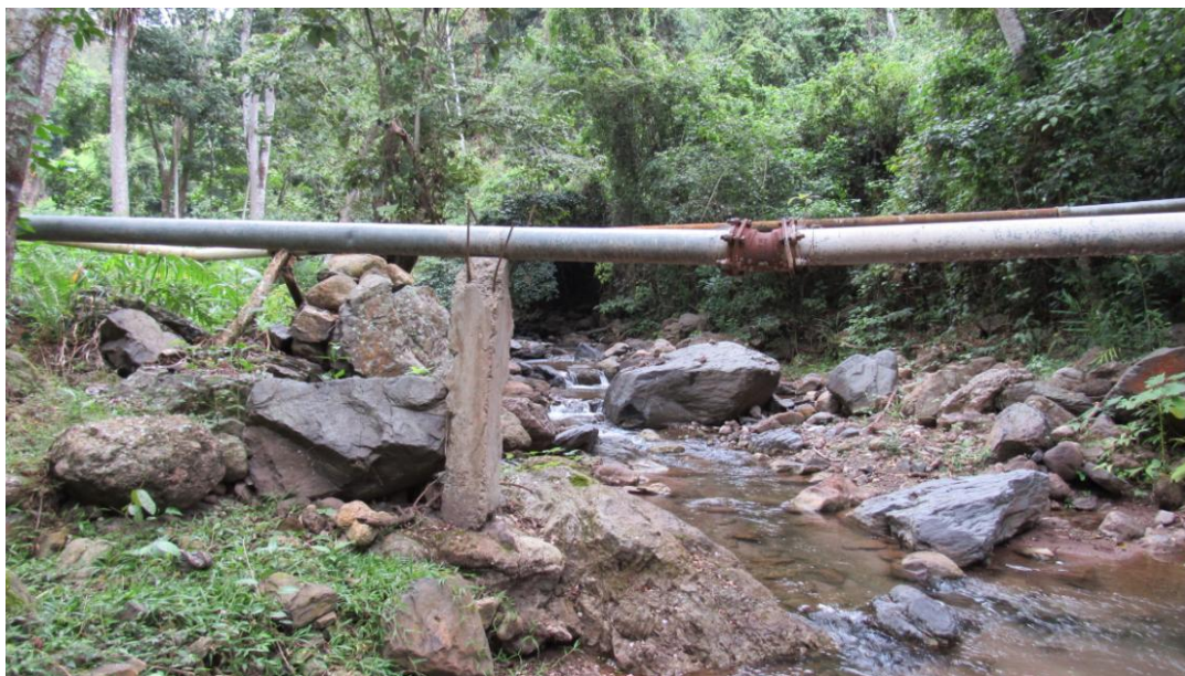
Cruce aéreo apoyado en una columna de concreto en mal estado
