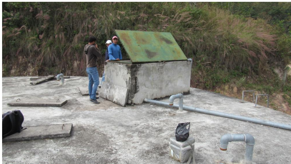
Tanque de 100,000 gls, sobre la losa existe una caja distribuidora
