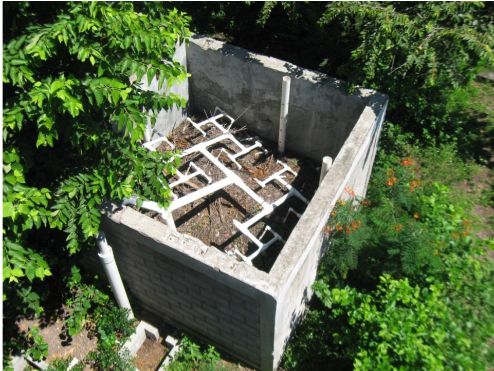
Vista superior de la infraestructura destruida y abandonada de la planta depuradora
