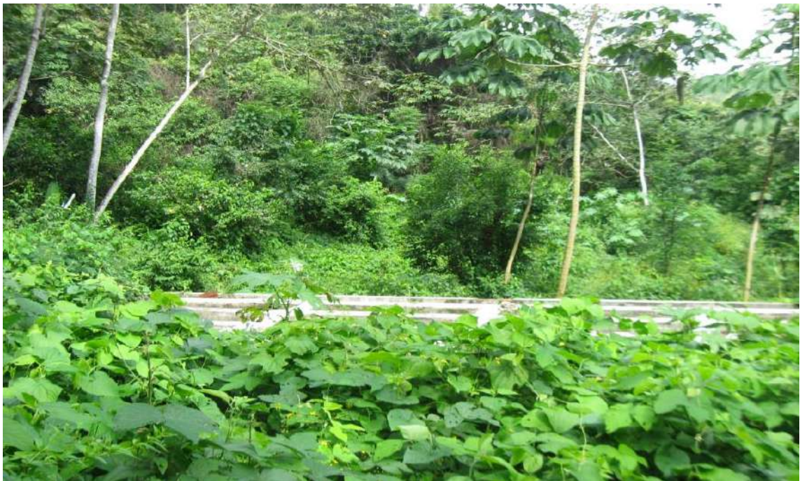
Estructura de sedimentación primaria de la planta depuradora que no está en funcionamiento en el casco urbano de Ojos de Agua
