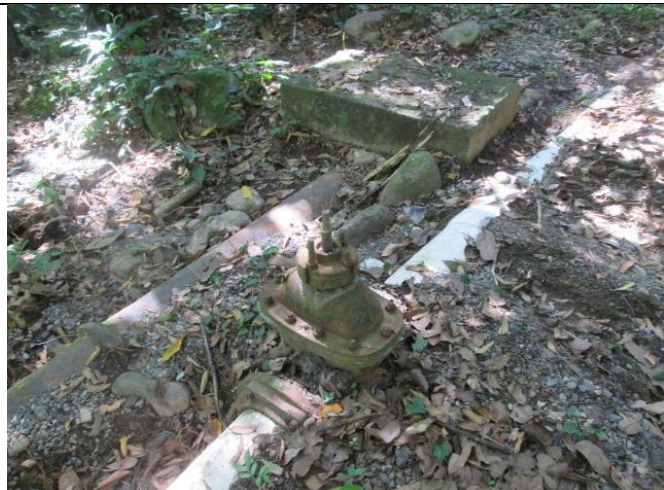
Válvula de control de línea de presa pimienta a tanque Agalteca cuadrado
