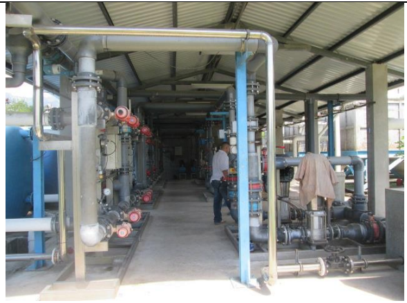
Cuarto de bombas y distribución
