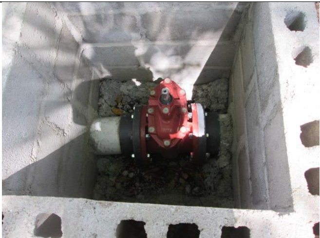
Válvula de control de línea nueva de Uchapa a tanque Agalteca
