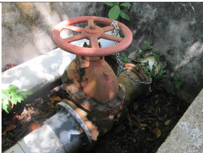
Válvula de tubería de Limpieza
