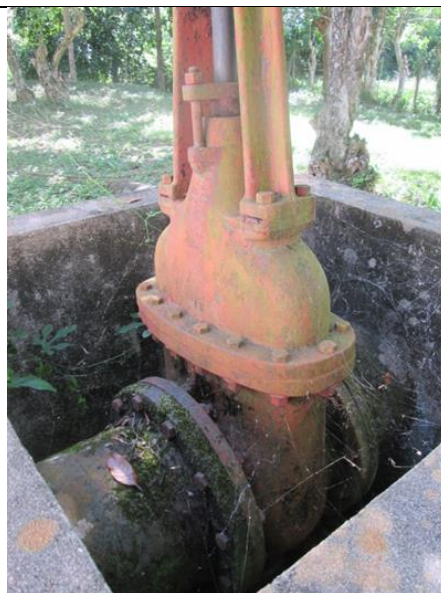
Válvula de rebose del tanque
