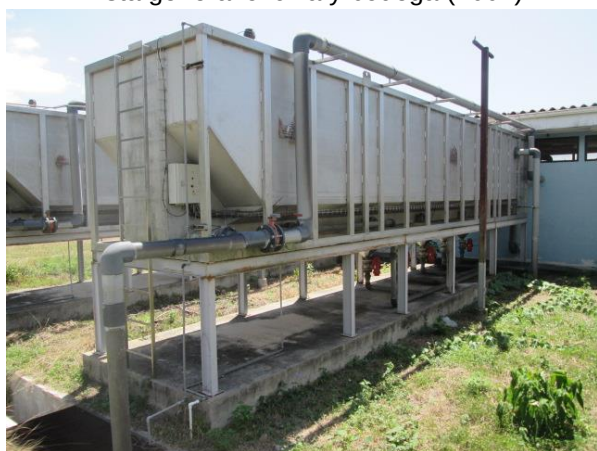
Vista general decantadores
