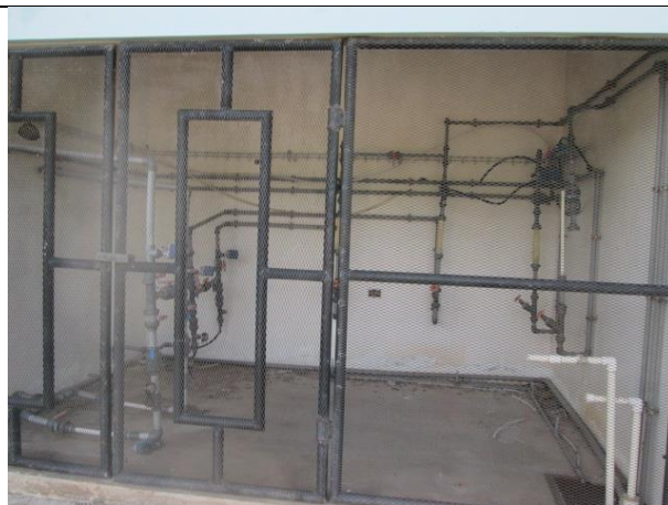
Vista cuarto de aplicación de químicos
