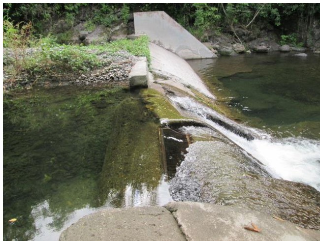
Vista de rejilla
