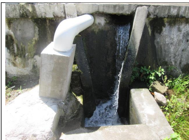
Vista tubería de entrada y rebose
