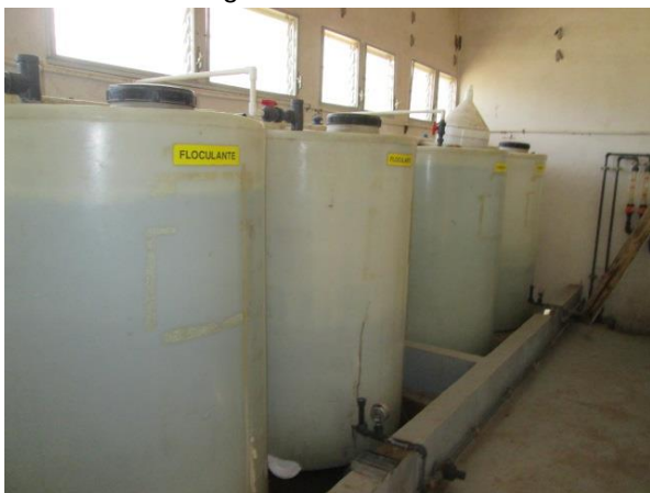
Tanques de almacenamiento de químicos
