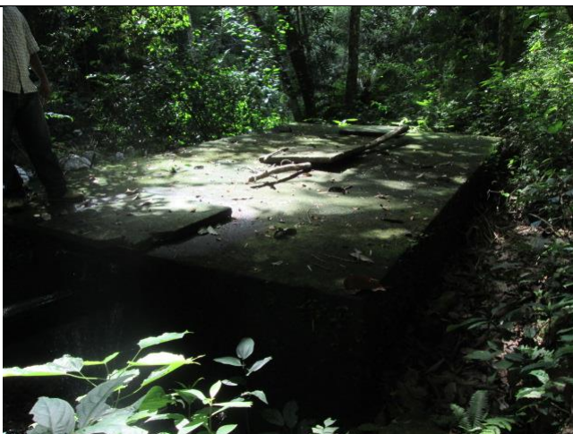
Desarenador en línea de conducción de presa Pimienta a tanque Agalteca cuadrado
