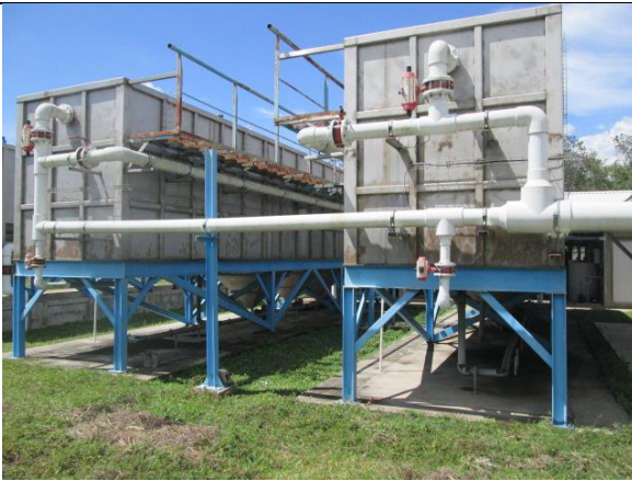
Vista general decantadores
