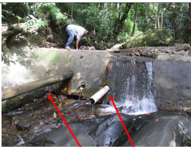
Vista de la tubería de salida y tuberías de limpieza sin tapones ni válvulas.
