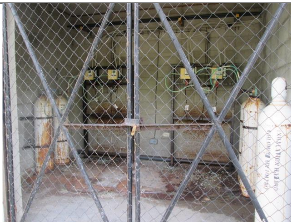
Aplicación de cloro gas
