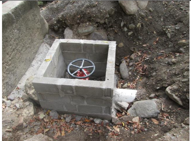
Válvulas de control en línea nueva de presa Uchapa a tanque Agalteca de 200,000 en salida del desarenador
