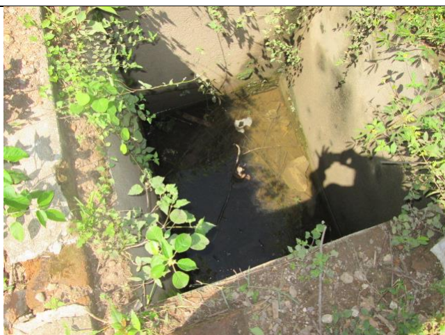
Estado de válvula de salida (anegada)
