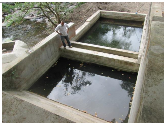
Desarenador línea Uchapa tanque Agalteca de 200,000 galones
