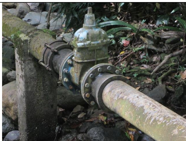
Válvula de control en línea de conducción de presa pimienta a desarenador
