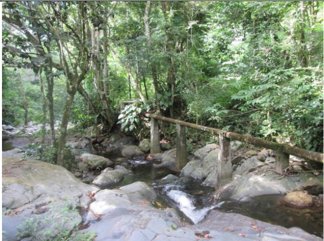
Línea de conducción de presa Pimienta a tanque Agalteca cuadrado
