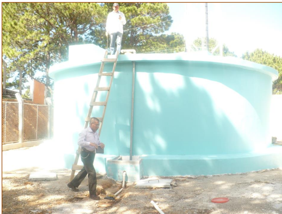
Tanque de almacenamiento, Proyecto por inaugurarse. Beneficiará al casco urbano y las comunidades de: El Tablón, Los Patios, Dos Caminos, Roblones y Chancoyote
