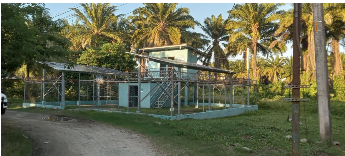
Visita a Tanque elevado, caseta de bombeo y tratamiento de agua del acueducto de la comunidad de Campo Las Flores
